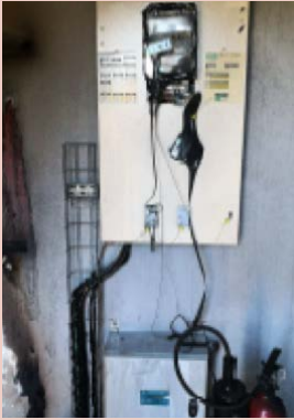
Dommages sur armoire électrique
